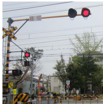
オーバーハング型踏切警報機
