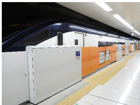
空港第2ビル駅ホームドア
